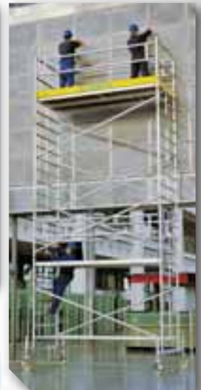
Fahrgerüst mit Fahrbalken
